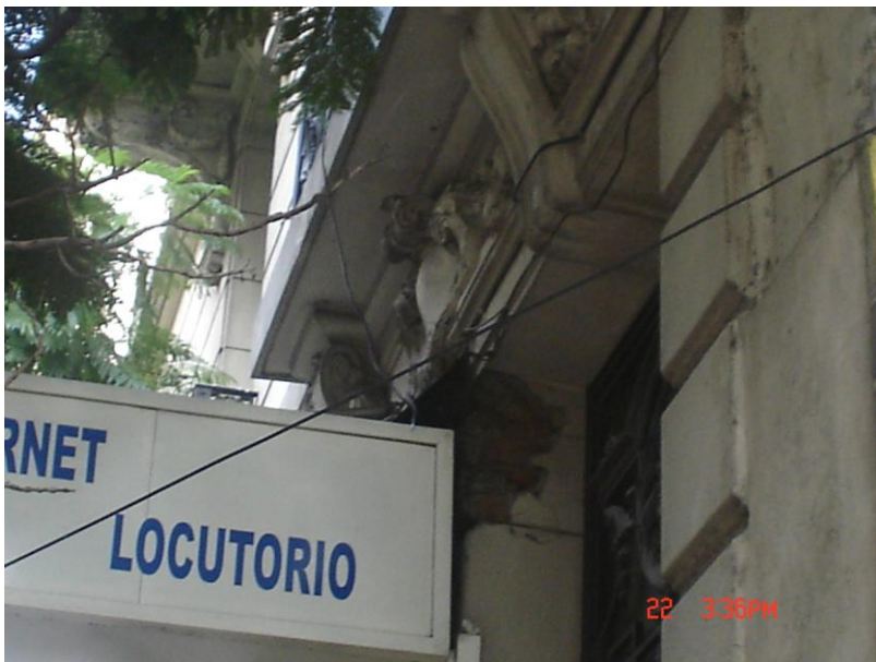
Marquesina del locutorio .Encuentro con el símil piedra, intervención incorrecta.
