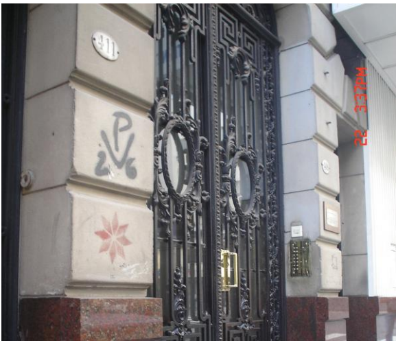
Insertos no originales en revestimiento símil piedra; graffiti; intervención anterior: pintura sobre símil piedra. Verificar basamento de granito
